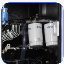
Filtro separador de partículas de combustible
