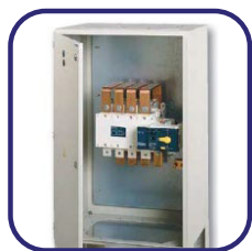
Quadro de comutação motorizada Socomec
