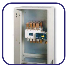
Cuadro de conmutación motorizada Socomec
