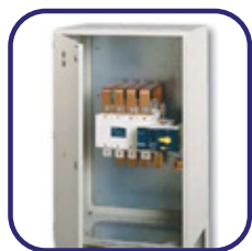
Quadro de comutação motorizada Socomec
