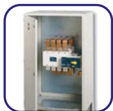
Inverseur de source automatique Socomec
