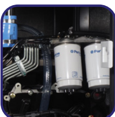
Filtro separador de partículas de combustível
