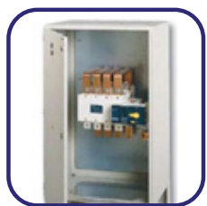
Cuadro de conmutación motorizada Socomec
