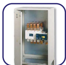
Quadro de comutação motorizada Socomec
