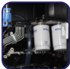
Filtro separador de partículas de combustível
