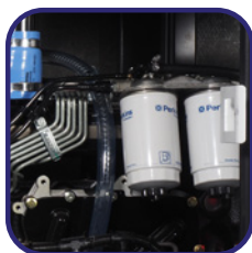
Filtro separador de partículas de combustível
