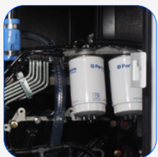
Filtro separador de partículas de combustível
