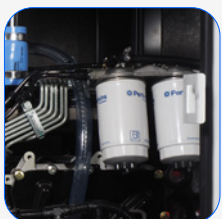
Filtro separador de partículas de combustível
