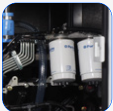
Filtro separador de partículas de combustível
